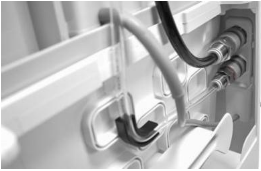
Abb. 7.4.2.7: Anschluss Stromkabel, AWZ & Spülvorrichtung
