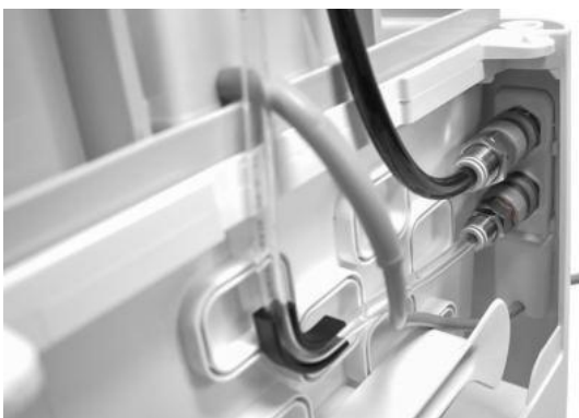
Abb. 6.3.4.4: Anschluss Stromkabel, AWZ & Spülvorrichtung
